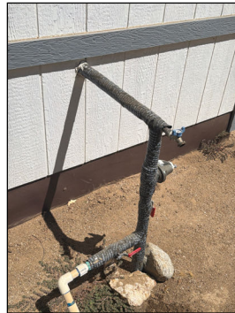
Tubería oculta con cinta de PVC
