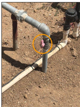
Válvula principal de cierre de gas
