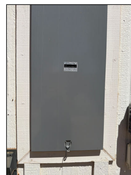
Exterior del subpanel
