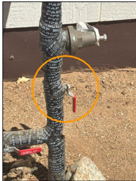
Válvula principal de cierre de agua
