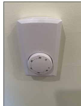
Control de calefacción en cada baño
