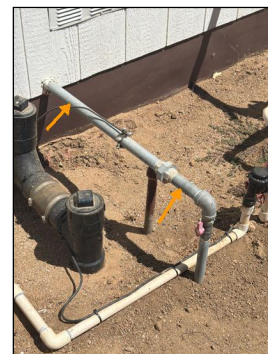
Tubería de gas mostrada como referencia
